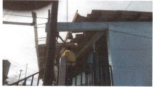
Foto 2: Lamina quebrada. Modulo 3.
